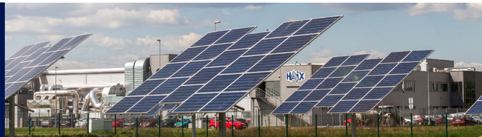
En Croatie, 4 542 m 2 de surface (972,3 kWp*) d'installations photovoltaïques ont été installées en 2024.
