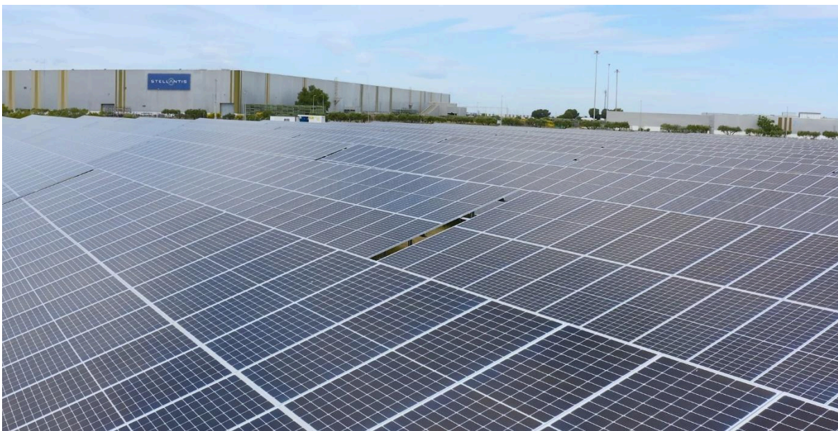
Installation renouvelable de Prosolia Energy située à Stellantis Saragosse
