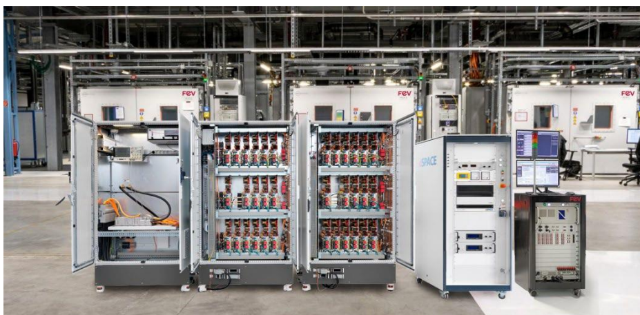
FEV et dSPACE apportent aux clients de l'industrie automobile des bancs de test HIL de puissance personnalisés, parfaitement intégrés aux centres d'essai. Source : FEV
