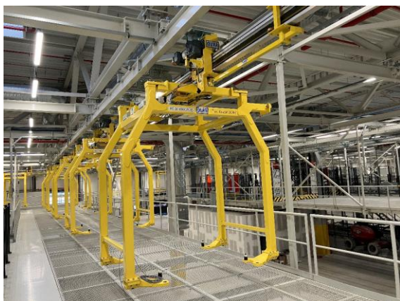
Photo 4 : Les convoyeurs aériens électriques de Dürr acheminent les carrosseries tout au long du processus d'assemblage final à Košice
